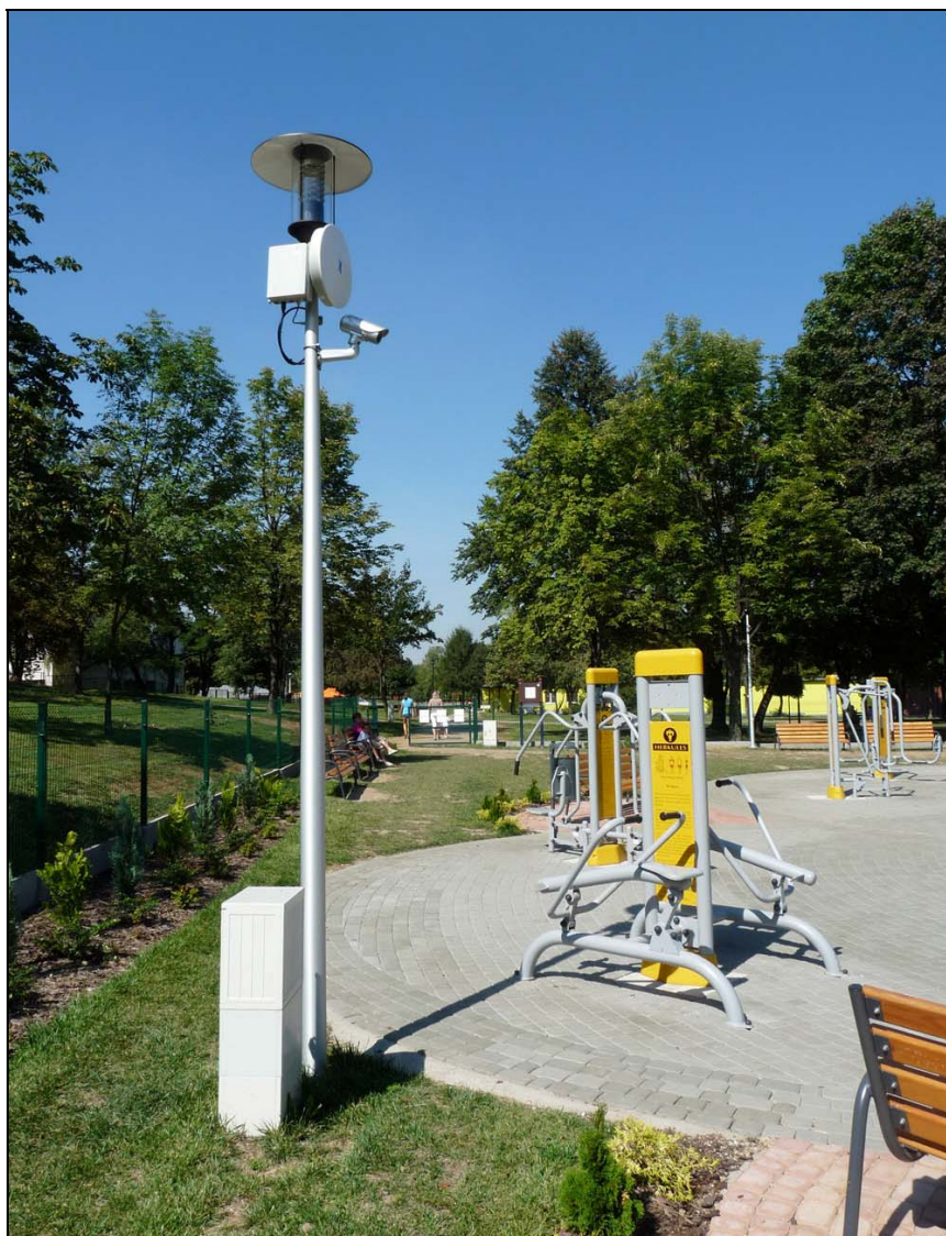
Fot.8 Urządzenia do obsługi monitoringu (kamera VIVOTEK IP7361) i punktu dostępowego Wi-Fi (DishEter Duo 23 WideBand) - tu na zdjęciu umieszczone na latarni oświetleniowej w Strefie Aktywności Rodzinnej, przy ulicy Małobądzkiej w Będzinie.
